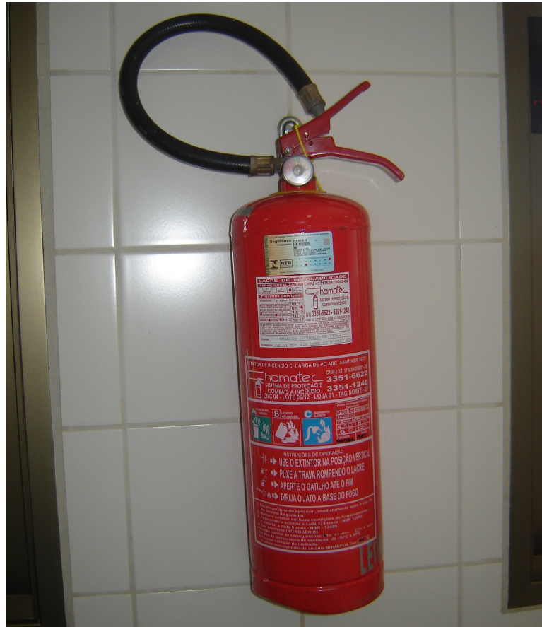
Figura 6 - Extintor de incêndio
